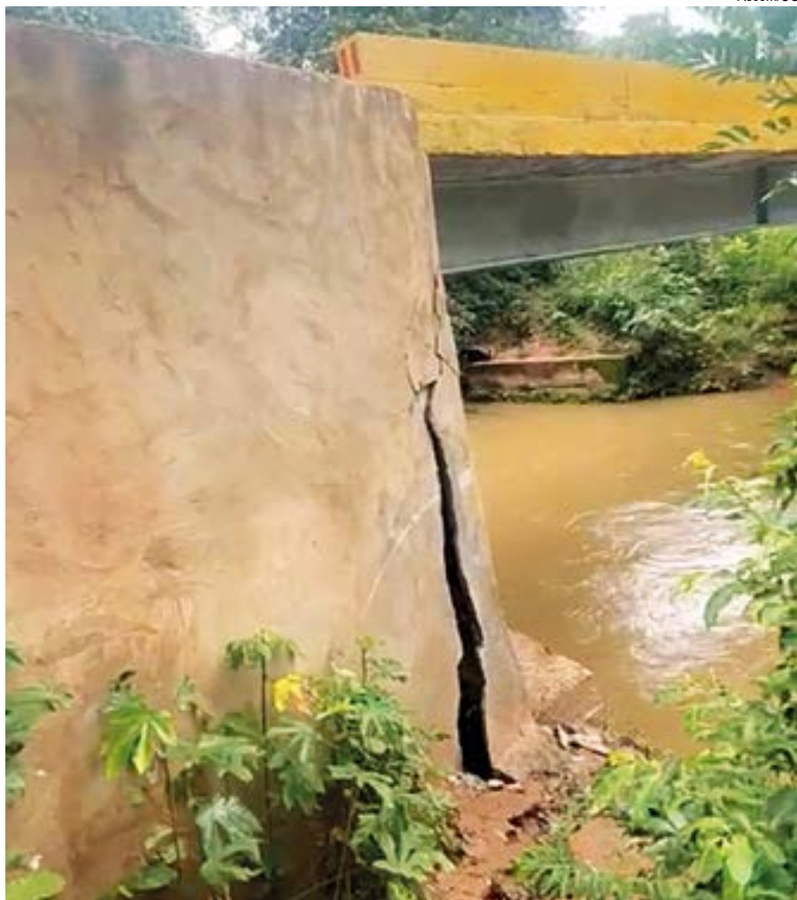
A Prefeitura notificou empresa para realizar reparos na ponte
